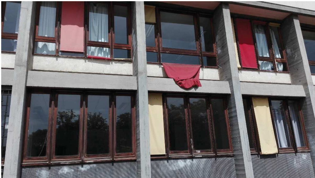
Détail sur menuiseries et protections solaires défectueuses (façade sud bât F)
